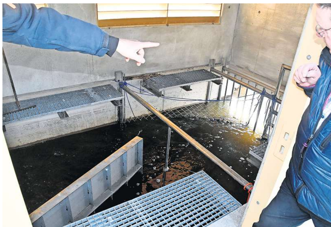
So funktioniert der Prototyp des Sperrwerks: Das Bauwerk am Auslauf des Saiser Baches in den Kleinen Jasmunder Bodden verhindert sowohl das Eindringen von Wasser als auch von Fischen aus dem Bodden in den Bach und damit die Wostevitzer Teiche.
